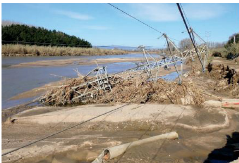
AFECTACIÓ D'UNA TORRE D'ALTA TENSIÓ A LA PLANTERA, MARGE ESQUERRE DEL TORDERA
