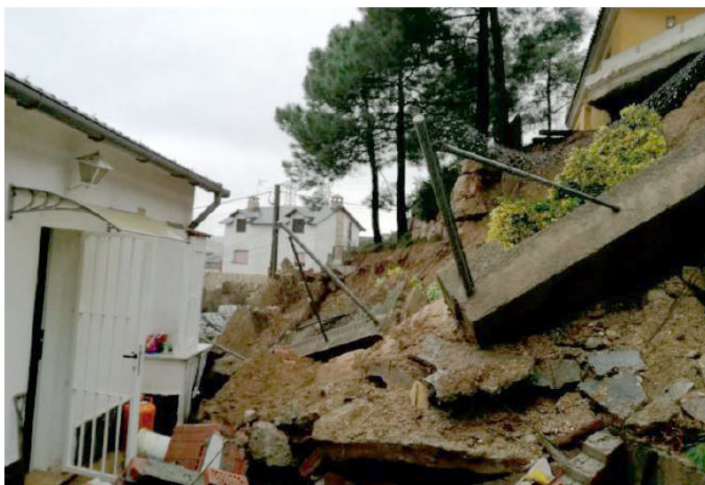
DANYS EN HABITATGES A SANTA MARIA DE PALAUTORDERA
